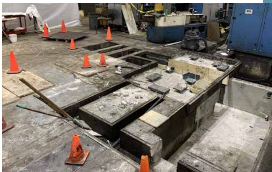
➔ Aus alt mach neu – Schritt 2: Das Fundament für die neue Maschine wird gelegt.
