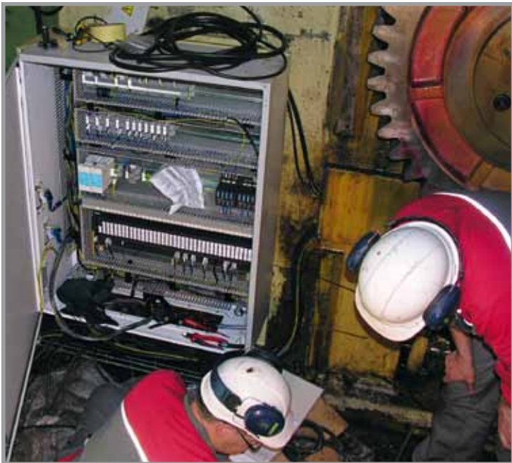
Installation und Verdrahtung des neuen Hauptklemmenkastens an der Maschine.
