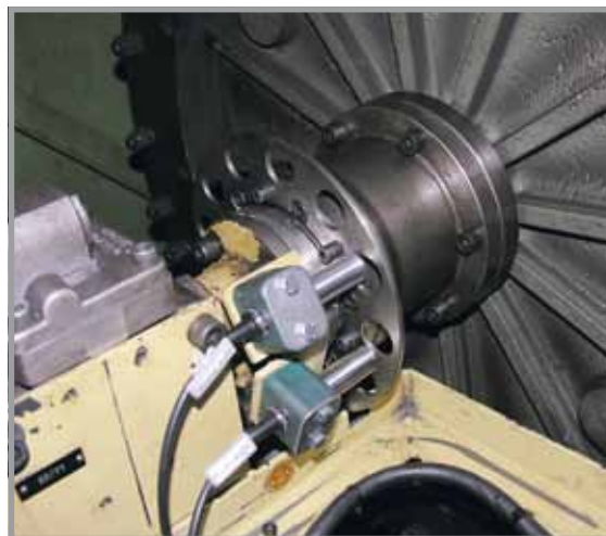
Die neue Stillstandsüberwachung sowie die Zuhaltensysteme von Garrisson und Schmersal sind notwendig und Bestandteil zur Einhaltung der gesetzlichen Vorschriften der Maschinenrichtlinien.
