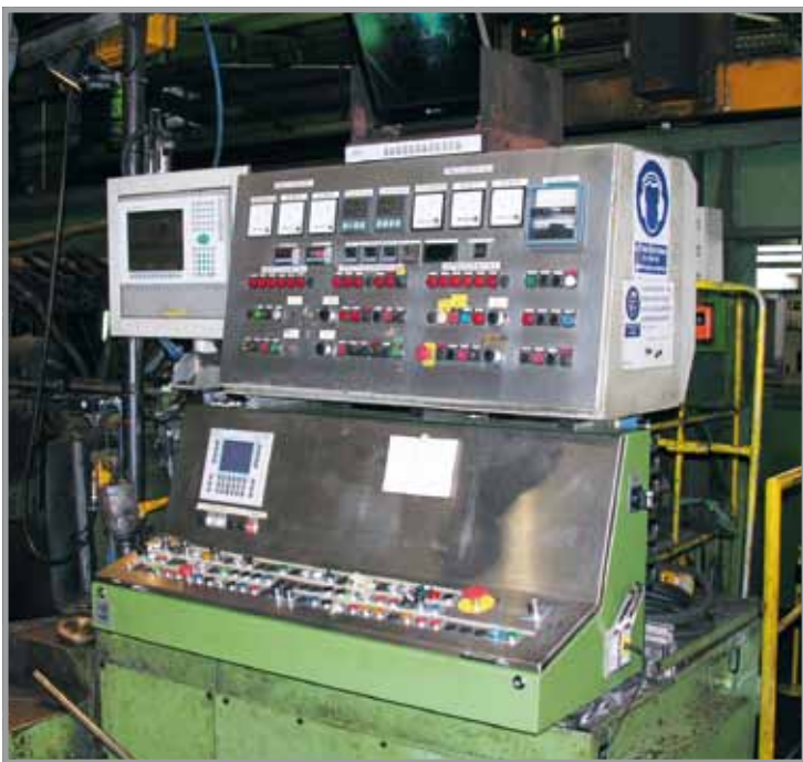
Das neu positionierte und installierte Bedienpult für die Maschine, das ESA600, die Presskraftüberwachung und die Heizung.
